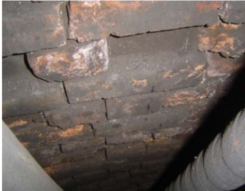
Rys. 9. Ubytki pojedynczych cegieł oraz zaprawy Fig. 9. Losses of single bricks and mortar
