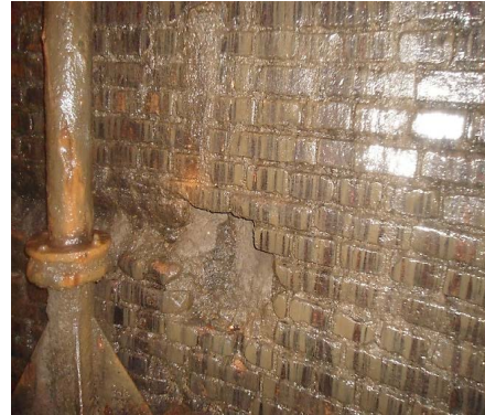
Rys. 10. Przykładowe głębokie ubytki obudowy murowej Fig. 10. Sample deep losses of the support
