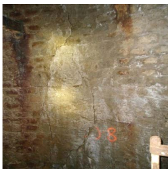
Rys. 1. Spękania obudowy murowej z betonitów Fig. 1. Fractures of bentonite brick lining
