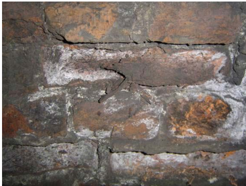
Rys. 11. Korozja obudowy murowej Fig. 11. Corrosion of the brick lining
