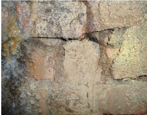
Rys. 19. Lekkie sączenie wody z za obudowy szybu
