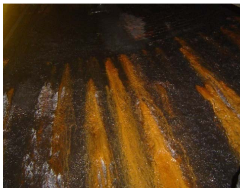
Rys. 15. Wycieki i sączenia wody z za obudowy
