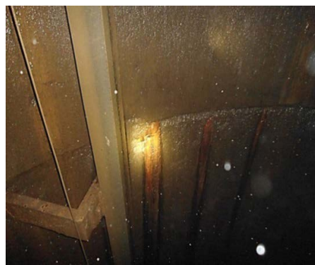
Rys. 18. Wyciek na połączeniu technologicznym
