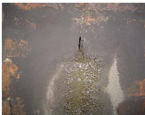
Rys. 17. Wyciek z nieszczelnej spoiny
