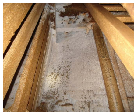
Rys. 14. Zanieczyszczenie obudowy osadem solnym Fig. 14. Contamination of support through the salt sediment
