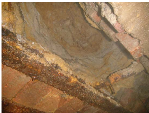
Rys. 6. Widok ubytku warstwy gliny w stropie wnęki w bezpośrednim sąsiedztwie szybu
