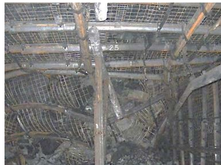
Rys. 13. Widok zawalu wyrobiska w obudowie ŁProB7/7,6/4 (Szostek 2016)
