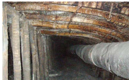
Rys. 11. Wzmocnione w miejscu przegięcia odrzwi obudowy ŁPrP (zdjęcie własne)
