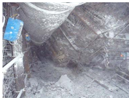
Rys. 15. Widok zawalu wyrobiska w obudowie ŁProj 6,4/3,6 (Szostek 2016)
