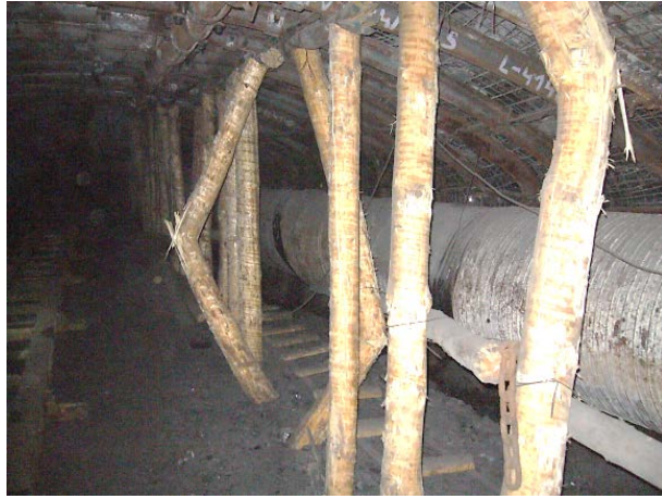
Rys. 4. Widok złamanych stojaków drewnianych w rozcince ścianowej rozruchowej w obudowie ŁPrP w rozstawie odrzwi obudowy co 0,75 m
