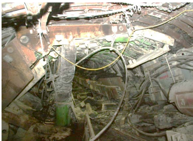
Rys. 10. Zabudowana sekcja obudowy zmechanizowanej FRS19/45-2 × 3056 w rozcince ścianowej rozruchowej w obudowie ŁP3R-V32/4/8,2 × 3,8
