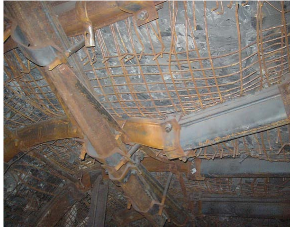
Rys. 7. Widok deformacji obudowy ŁPKO/V32/10/10 wzmocnionej stojakami stalowymi w rozstawie odrzwi obudowy co 0,75 m w rejonie wpływu krawędzi eksploatacyjnych
