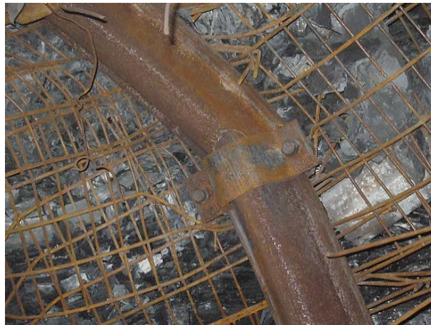
Rys. 8. Widok pękniętych odrzwi obudowy ŁPKO/V32/10/10 wzmocnionych stojakami stalowymi w rozstawie odrzwi obudowy co 0,75 m w rejonie wpływu krawędzi eksploatacyjnych
