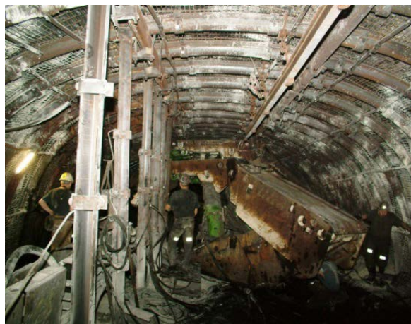
Rys. 11. Zabudowa sekcji obudowy zmechanizowanej FRS19/45-2 × 3056 w rozcince ścianowej rozruchowej w obudowie ŁP3R-V32/4/8,2 × 3,8
