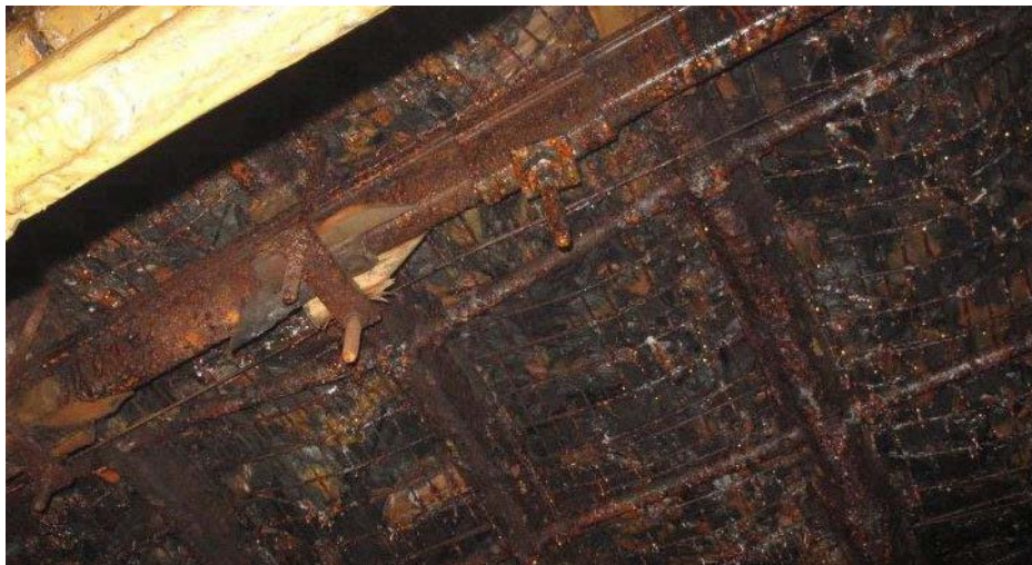
Rys. 2. Wzmacnianie obudowy łukowo podatnej przed frontem ściany z zastosowaniem długiej obudowy kotwowej strunowej o długości 6 m w chodniku podścianowym w kopalni podziemnej (fot. K. Skrzypkowski)
